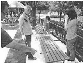
やすりがけの後はペンキ塗り・・・まだ下塗りですよ
